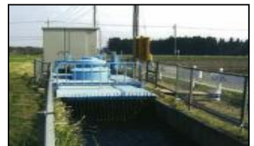
マイクロ水力発電施設
